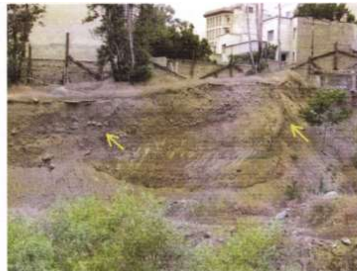
شکل شماره ۲۹- برشی از گسله نیاوران در دیواره باختری گودبرداری واقع در منطقه یک- نیاوران
